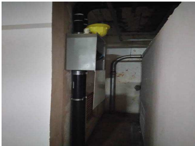
Figura 1E: infraestrutura ramal BT para medição
