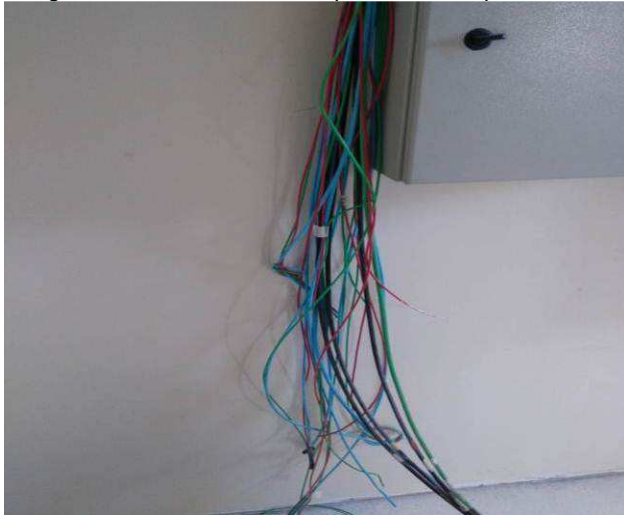
Figura 19E: cabeamento elétrico rede estabilizada 1º pavimento
