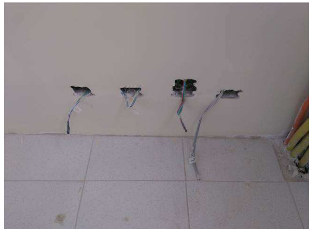
Figura 66E: infraestrutura instalada em alvenaria para cabeamento estruturado.
