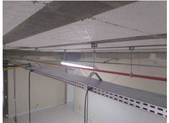
Figura 14E: eletrocalhas tampadas 1º e 2º pavimentos
