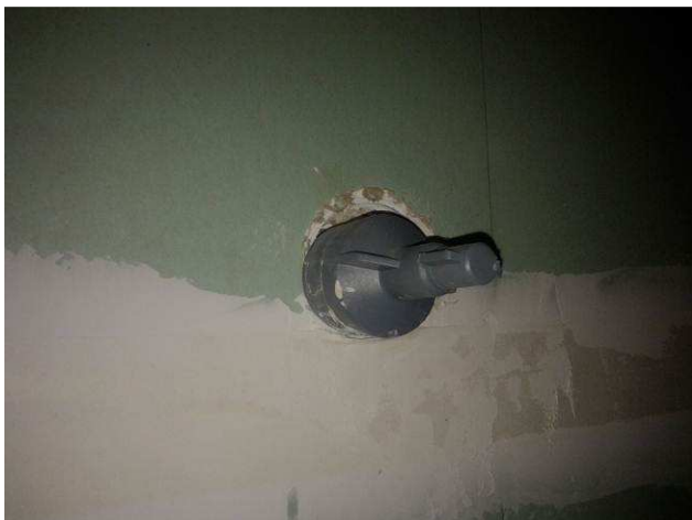
Figura 47C: Registro de pressão 3/4", instalado no vestiário
