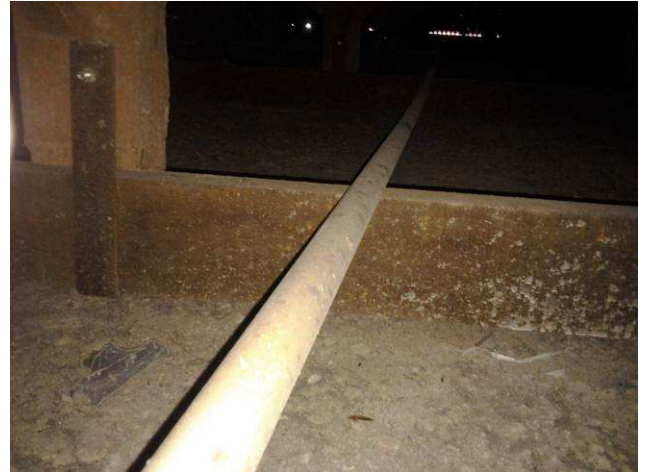
Figura 40C: Tubo de PVC 32mm utilizado na ligação dos ramais alimentadores
