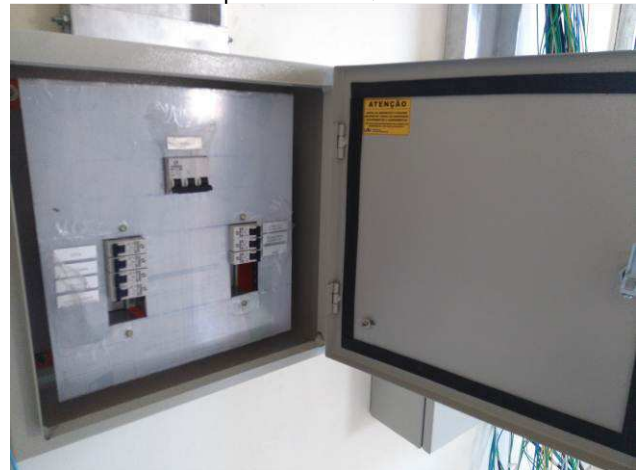
Figura 54E: Quadro elétrico rede estabilizada 1º pavimento - QDE1
