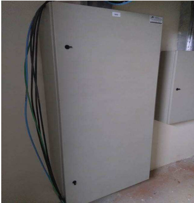
Figura 25E: quadro elétrico geral QDG
