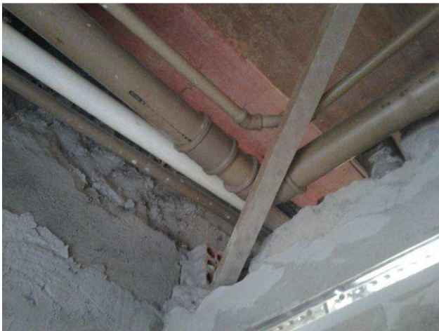
Figura 41C: Tubo de PVC 32mm utilizado na ligação dos ramais alimentadores
