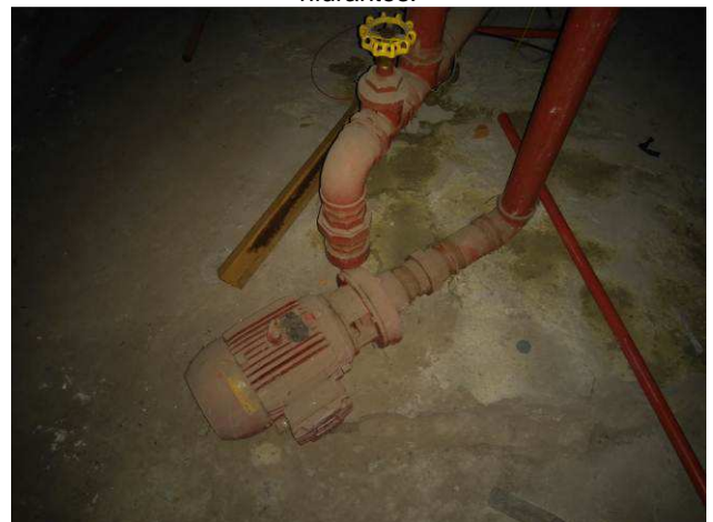
Figura 62E: bomba hidrantes (existente)
