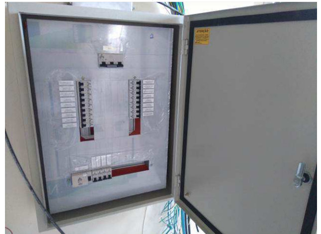
Figura 48E: Quadro elétrico rede comum 2º pavimento - QDC2
