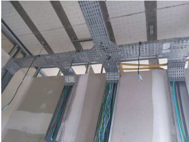
Figura 13E: eletrocalhas de descida quadros elétricos
