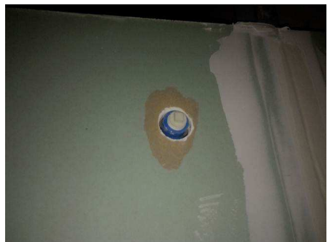
Figura 44C: Ponto da água fria 25mm instalado em parede de gesso acartonado verde
