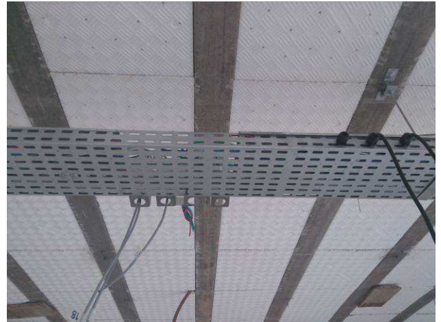
Figura 12E: eletrocalhas tampadas 1º e 2º pavimentos
