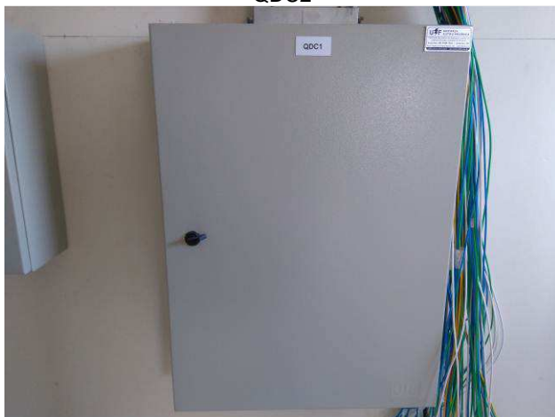
Figura 49E: Quadro elétrico rede comum 1º pavimento - QDC1
