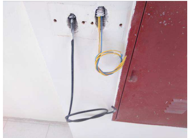
Figura 60E: cabeamento SDAI e acionamento bomba hidrantes.
