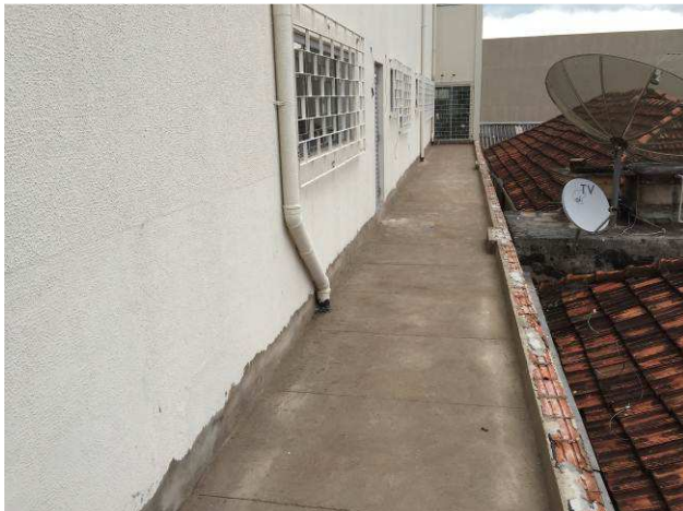
Figuras 23C: Detalhe da aplicação da camada de proteção mecânica no corredor lateral direito do primeiro pavimento
