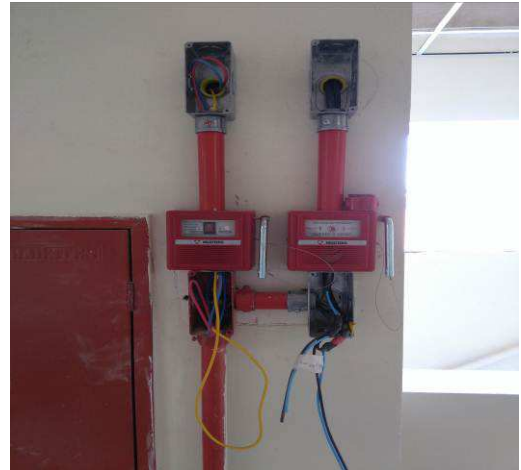
Figura 58E: cabeamento SDAI e acionamento bomba hidrantes.
