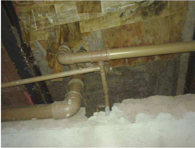
Figura 39C: Tubos de PVC 32mm utilizados na ligação dos ramais alimentadores
