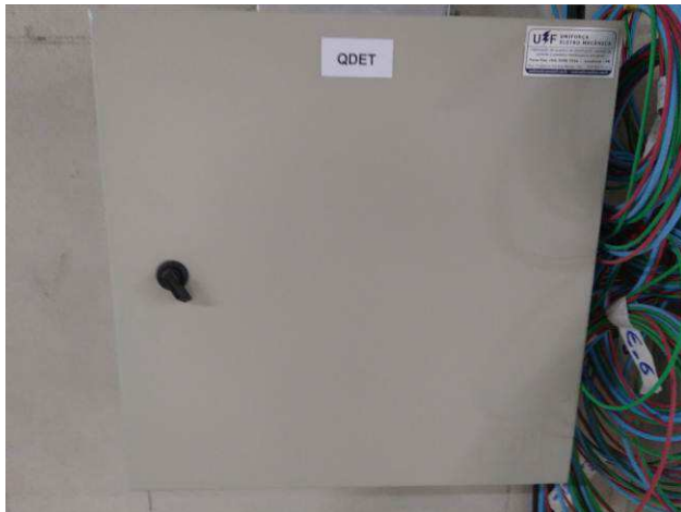
Figura 45E: Quadro elétrico rede estabilizada térreo - QDET
