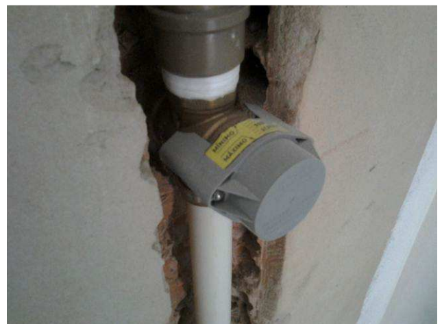
Figura 50C: Base para válvula de descarga, instalada no segundo pavimento
