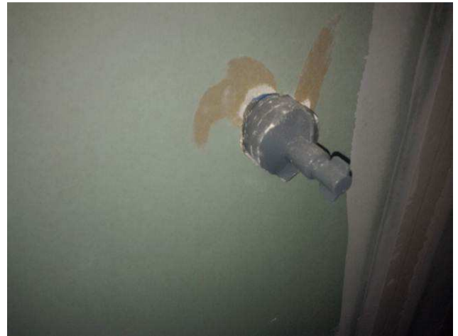
Figura 46C: registro de gaveta 3/4" instalado em parede de gesso acartonado, no térreo
