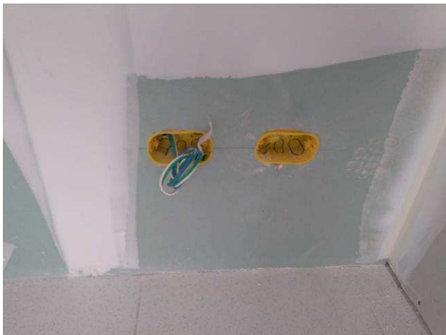
Figura 65E: infraestrutura instalada em drywall para cabeamento estruturado.
