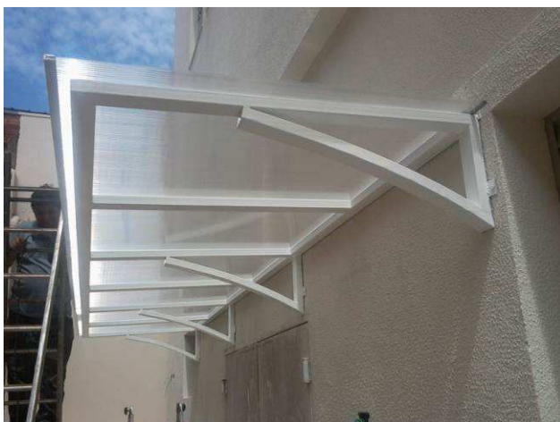
Figura 19C: Cobertura em policarbonato alveolar, instalada sobre a porta dupla da lateral esquerda do térreo
