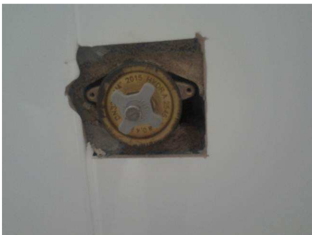
Figura 49C: Base para válvula de descarga, instalada no primeiro pavimento
