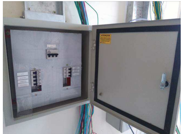
Figura 52E: Quadro elétrico rede estabilizada 2º pavimento - QDE2
