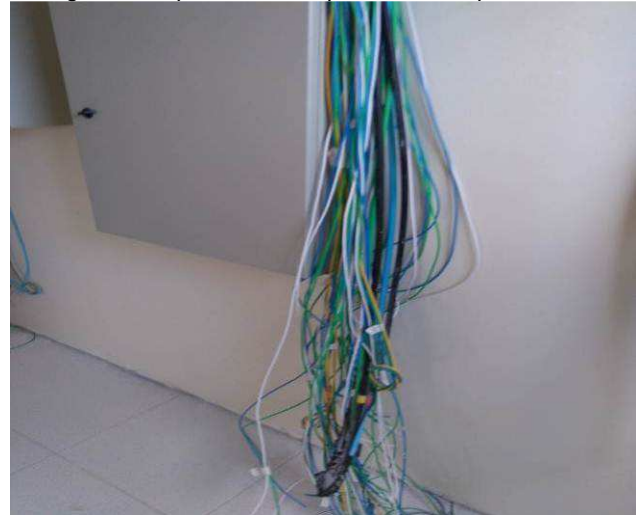
Figura 20E: cabeamento elétrico rede comum 1º pavimento
