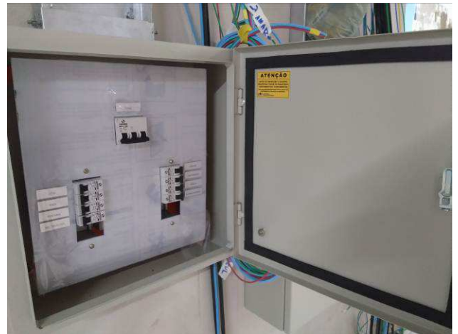
Figura 46E: Quadro elétrico rede estabilizada térreo - QDET
