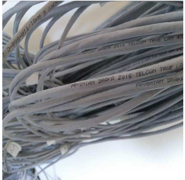
Figura 78E: cabearmento UTP cat 6 instalado
