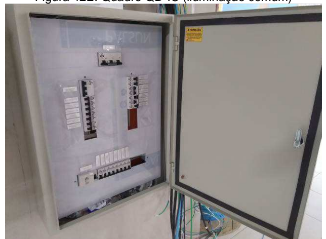
Figura 44E: Quadro elétrico rede comum térreo - QDCT
