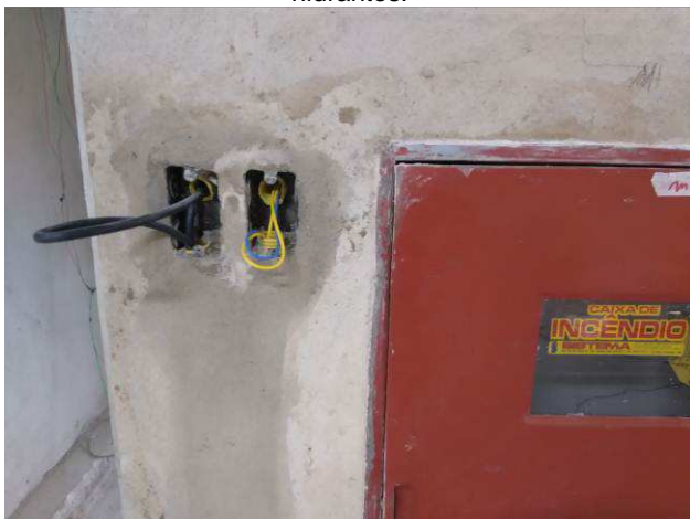
Figura 61E: cabeamento SDAI e acionamento bomba hidrantes.
