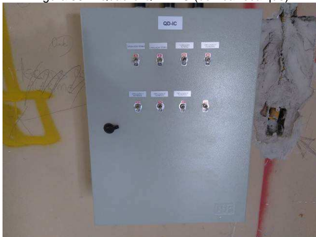
Figura 41E: Quadro QD-IC (iluminação comum)
