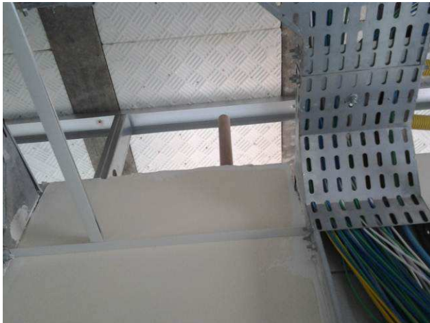
Figura 53C: Dreno para ar condicionado hi-wall, instalado no primeiro pavimento
