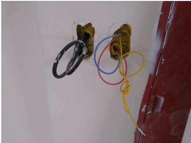
Figura 59E: cabeamento SDAI e acionamento bomba hidrantes.
