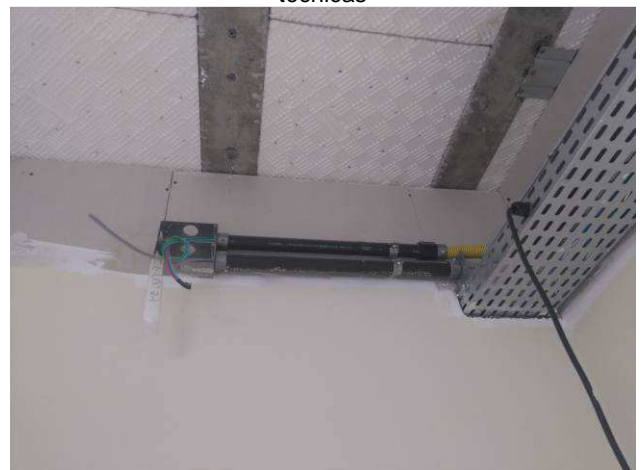
Figura 10E: condutores para CFTV
