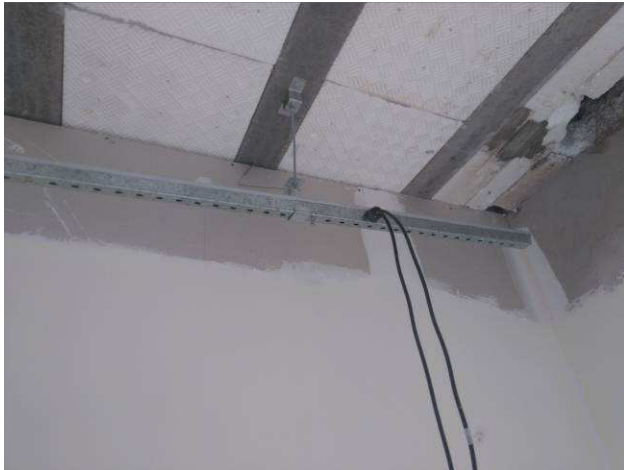
Figura 17E: eletrocalhas tampadas 1º e 2º pavimentos
