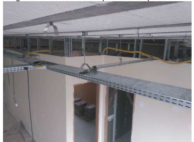
Figura 16E: eletrocalhas tampadas 1º e 2º pavimentos
