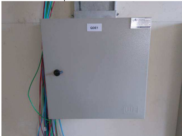
Figura 53E: Quadro elétrico rede estabilizada 1º pavimento - QDE1
