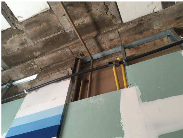
Figura 55C: Drenos para ar condicionado cassete e hi-wall, instalados no térreo.
