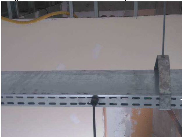
Figura 15E: eletrocalhas tampadas 1º e 2º pavimentos
