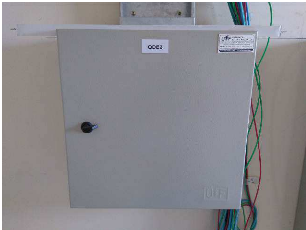
Figura 51E: Quadro elétrico rede estabilizada 2º pavimento - QDE2
