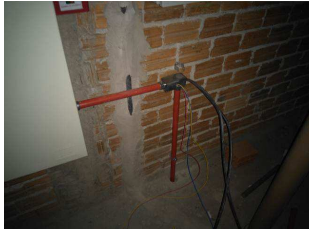
Figura 64E: Quadro QD INC para acionamento bomba combate a incêndios.
