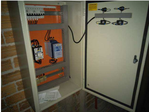
Figura 63E: Quadro QD INC para acionamento bomba combate a incêndios.
