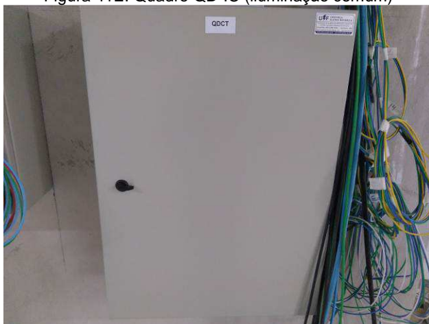
Figura 43E: Quadro elétrico rede comum térreo - QDCT
