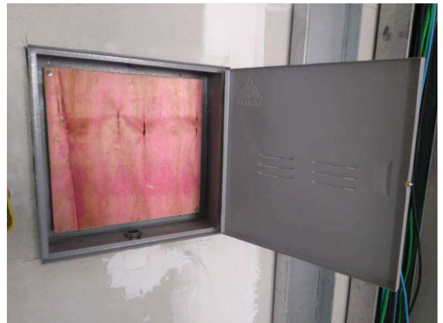
Figura 74E: caixa telefonia TRT
