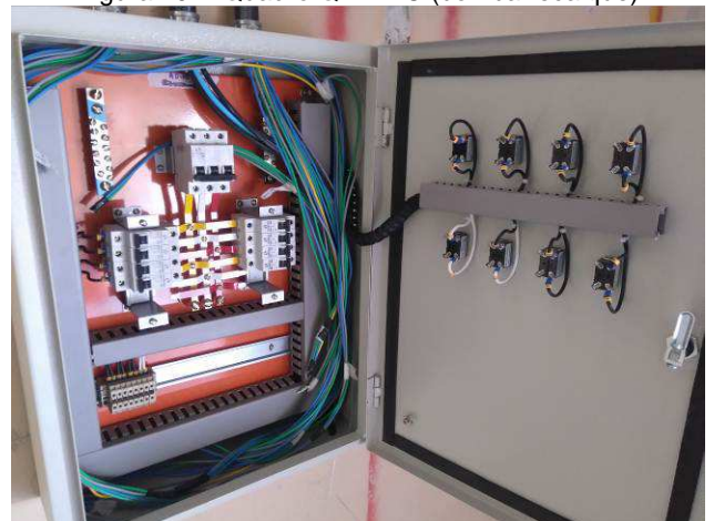
Figura 42E: Quadro QD-IC (iluminação comum)
