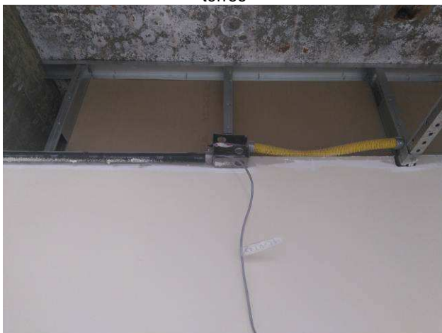
Figura 9E: condutores para CFTV
