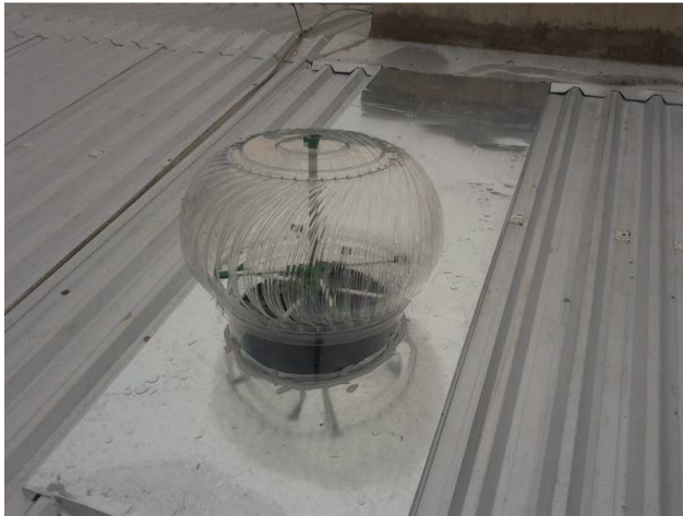
Figura 37C: exaustores eólicos instalados na cobertura
