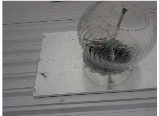
Figura 38C: exaustores eólicos instalados na cobertura
