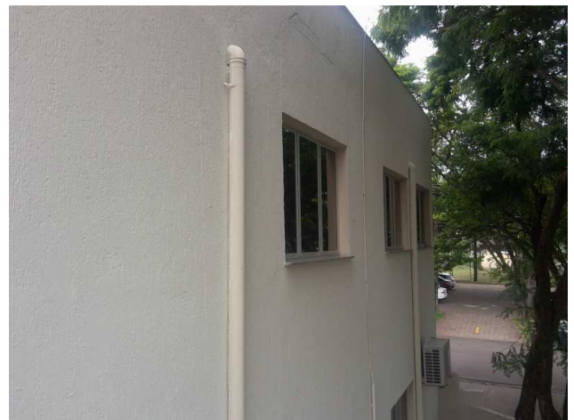
Figura 46C: tubos de captação pluvial, em PVC 100mm
