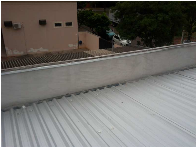
Figura 33C: rufo chapéu, instalado sobre a platibanda
