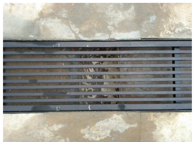
Figura 48C: canaletas com grelha para captação pluvial da calçada dos fundos do imóvel
