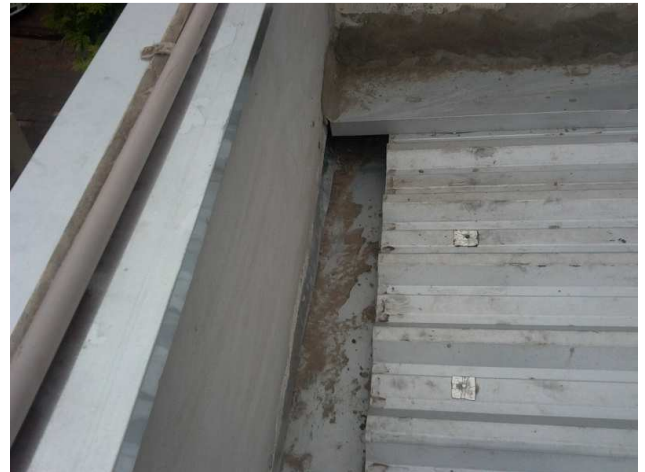
Figura 34C: rufo chapéu, instalado sobre a platibanda
