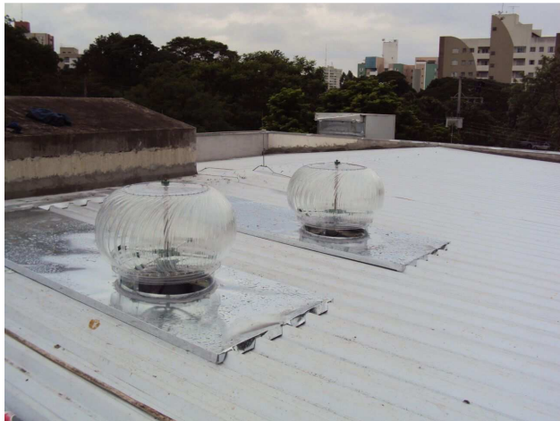
Figura 39C: exaustores eólicos instalados na cobertura
