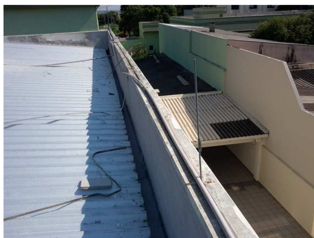
Figura 56C: Sistema SPDA após instalação
