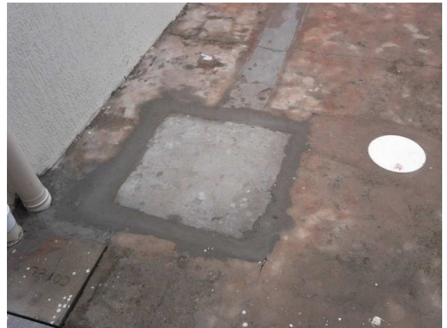
Figura 52C: Piso cimentado sobre lastro de concreto, no refazimento da calçada onde foram executadas valas de assentamento da tubulação de drenagem pluvial
