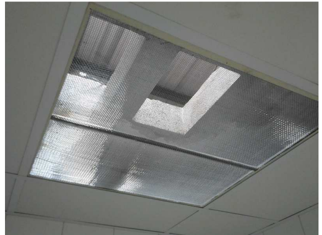
Figura 40C: grelha de ventilação dos sanitários
