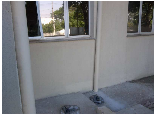
Figura 44C: tubos de captação pluvial, em PVC 100mm
