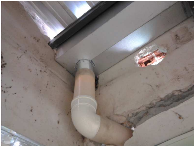
Figura 43C: tubos de captação pluvial, em PVC 100mm
