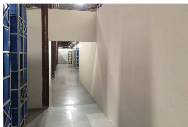
Figura 01C: Abertura de vão para ampliação e remoção da parede do depósito do RH.
