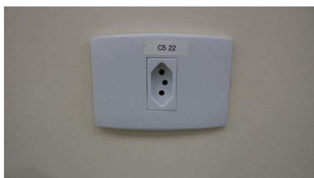
Figura 11E: Tomadas elétricas - sala refrigerada e múltiplo uso.
