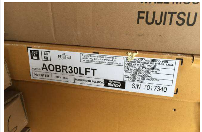
Figura 28C: Condensadora - modelo instalado.
