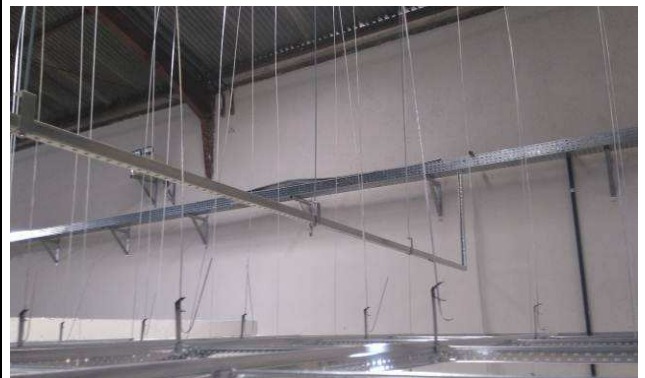
Figura 26E: infraestrutura de perfilados e eletrodutos - sala RH.
