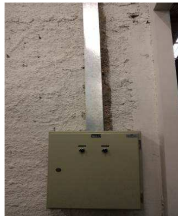
Figura 20E: quadro QDC17.
