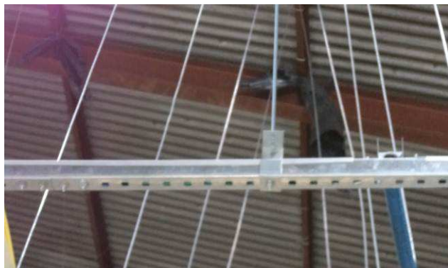
Figura 25E: infraestrutura de perfilados e eletrodutos - sala RH.
