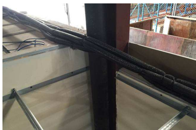
Figura 19C: Redes frigorígenas dos aparelhos de ar condicionado da Sala Refrigerada do almoxarifado.
