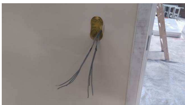
Figura 05E: cabeamento elétrico iluminação.
