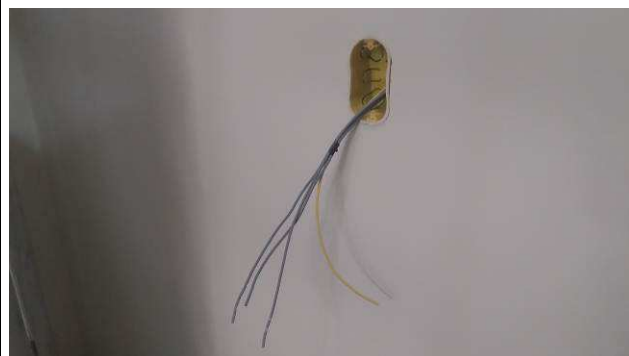
Figura 04E: cabeamento elétrico iluminação.
