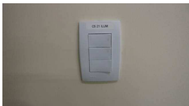
Figura 09E: interruptores - Sala refrigerada.
