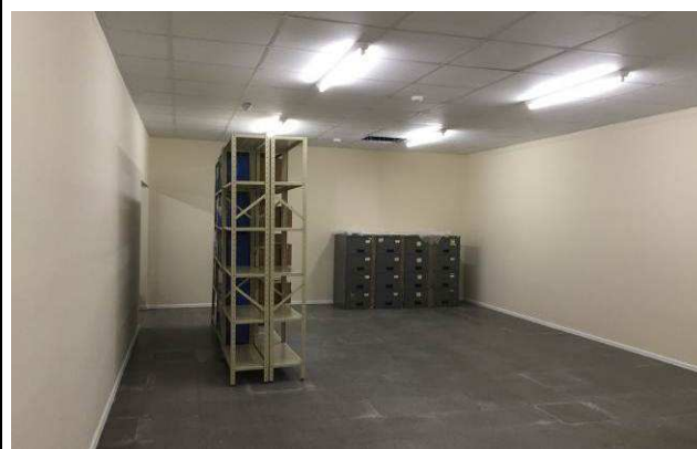
Figura 70C: Paredes de gesso acartonado / pintura interna / forro / rodapé - ampliação depósito do RH.
