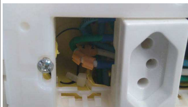
Figura 06E: cabeamento elétrico tomadas elétricas.
