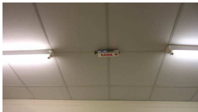
Figura 17E: bloco de emergência.
