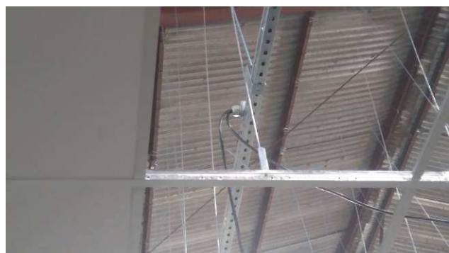
Figura 13E: cabeamento PP para luminárias.
