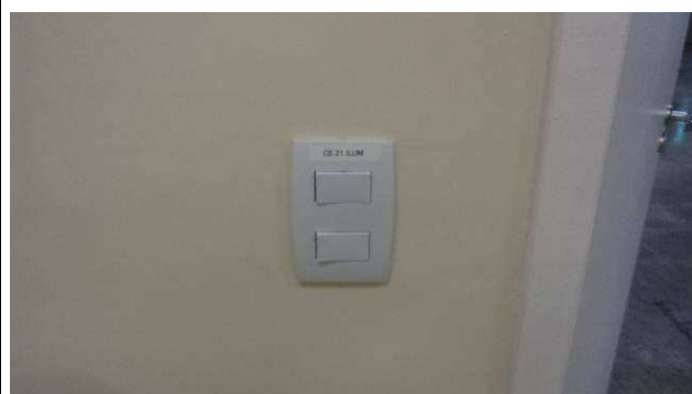
Figura 10E: interruptores - Sala múltiplo uso.
