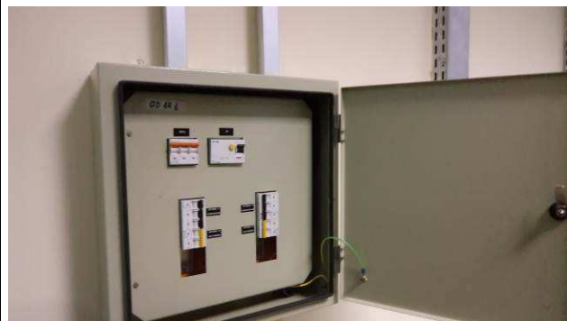
Figura 02E: perfilado descida quadro QDAR1.
