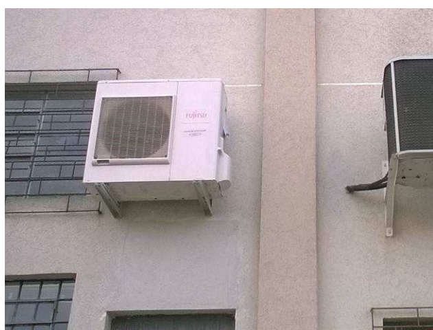
Figura 24C: Condensadora 2 - Service Desk.
