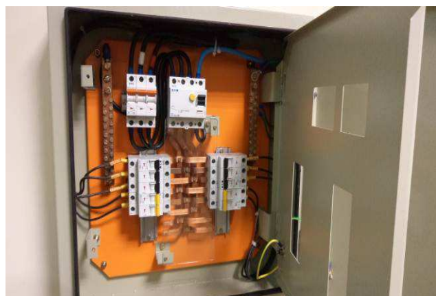
Figura 19E: quadro QDAR1.
