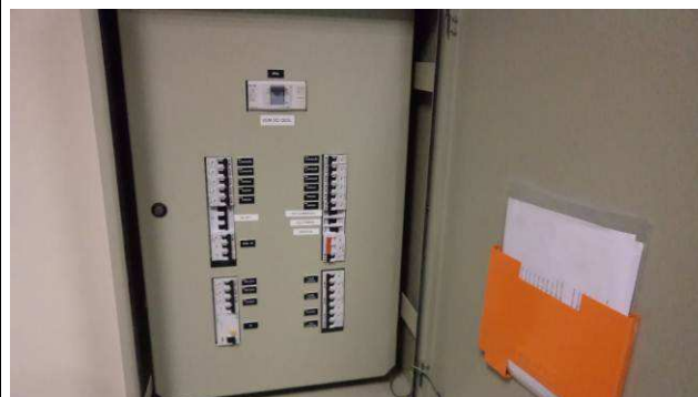
Figura 18E: Quadro QDC5.
