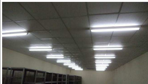
Figura 16E: luminárias 1x32 tipo calha sala múltiplo refrigerada.
