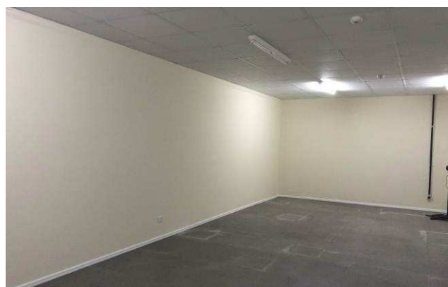
Figura 69C: Paredes de gesso acartonado / pintura interna / forro / rodapé - ampliação depósito do RH.
