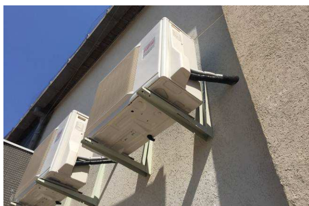
Figura 20C: Redes frigorígenas dos aparelhos de ar condicionado da Sala Refrigerada do almoxarifado.
