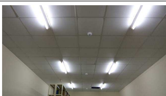
Figura 21E: Iluminação (luminárias e sensores de presença) - sala RH.
