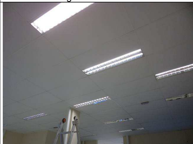
Figura 42E: luminárias 2x32W e blocos de emergência - secretaria.
