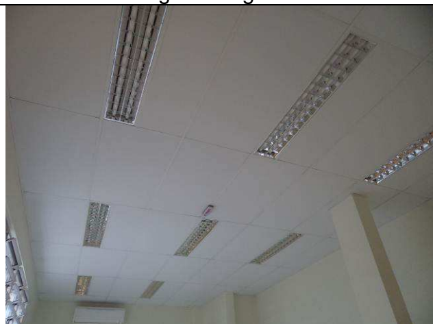
Figura 41E: luminárias 2x32W e blocos de emergência - audiências.
