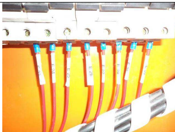
Figura 10E: cabeamento 2,5mm 2 Corfio - Corfitox - rede estabilizada.
