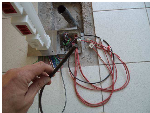
Figura 64E: cabeamento sonorização sala de audiências.
