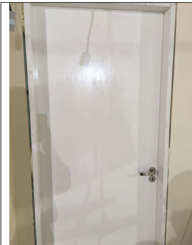
Figura 05C: Portas de madeira recusadas pela fiscalização por não atenderem às especificações e apresentarem baixa qualidade.
