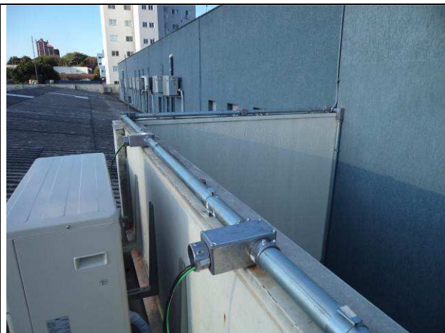
Figura 02E: infraestrutura em FG para alimentação condicionadores de ar.
