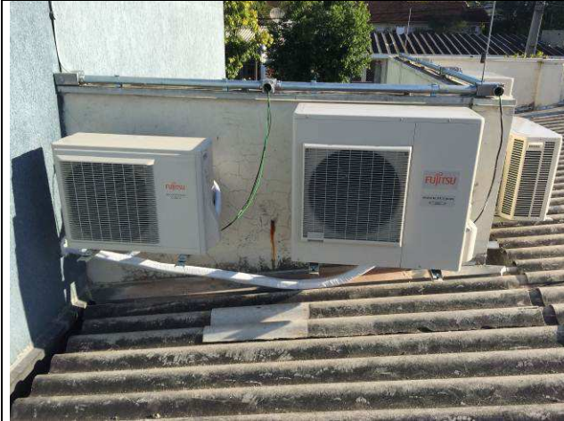
Figura 77C: Condensadoras na cobertura - 18.000 e 30.000 BTU's.
