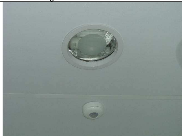
Figura 46E: luminária 23W e sensor de presença.
