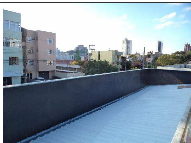
Figura 70E: SPDA - capttores e fitas de alumínio.
