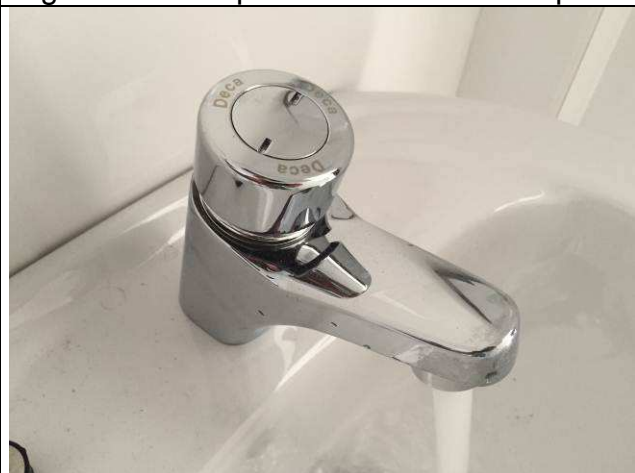
Figura 75C: Torneiras de lavatório.
