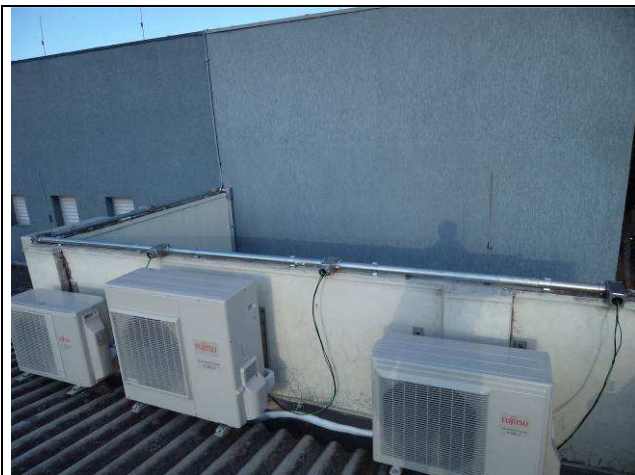
Figura 01E: infraestrutura em FG para alimentação condicionadores de ar.
