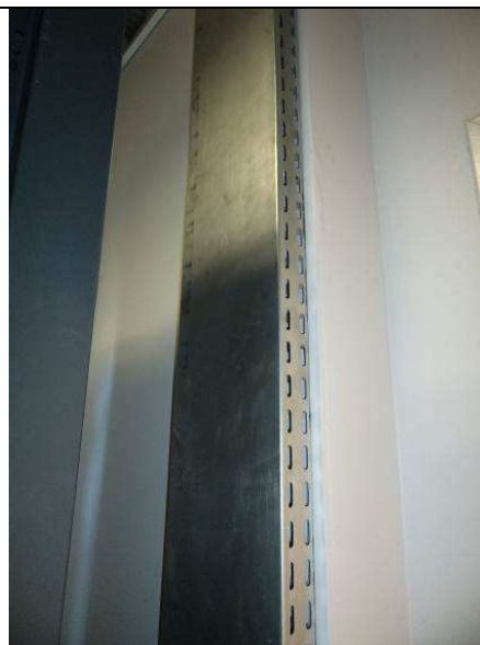
Figura 08E: eletrocalha descida rack, alinhada e tampada.
