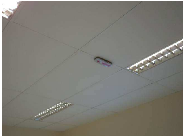
Figura 39E: luminárias 2x32W e blocos de emergência - gabinete.
