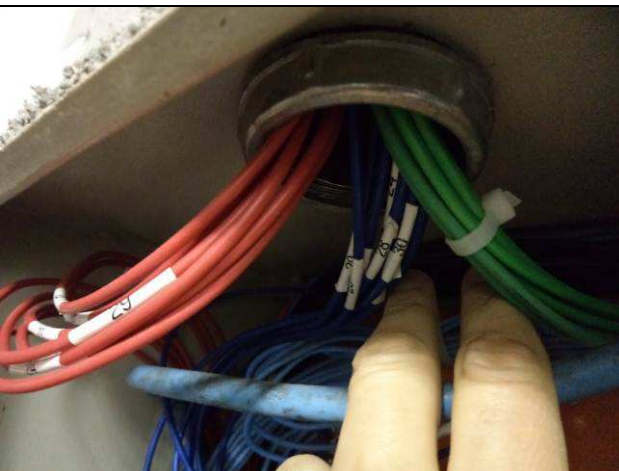
Figura 13E: cabeamento 2,5mm 2 Corfio - Corfitox - rede estabilizada.
