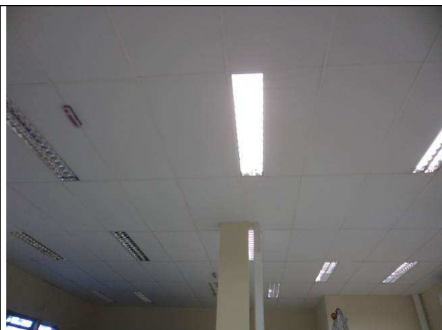
Figura 43E: luminárias 2x32W e blocos de emergência - secretaria.
