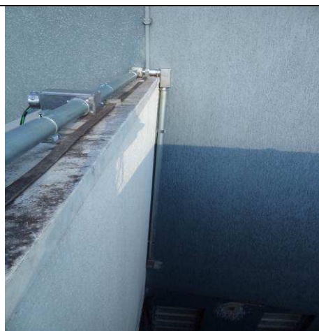
Figura 04E: infraestrutura em FG para alimentação condicionadores de ar.
