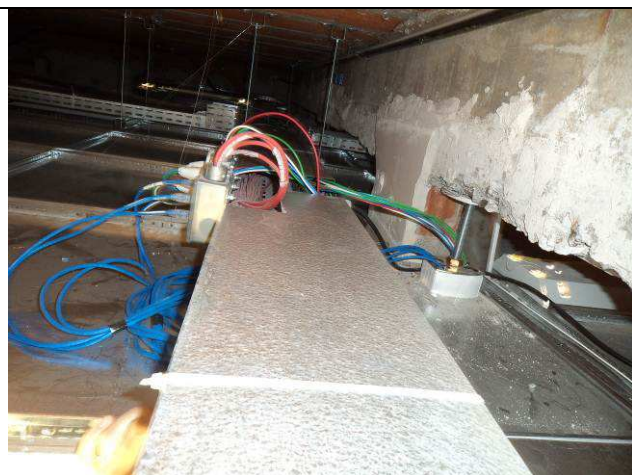
Figura 05E: eletrocalhas com septo divisor, alinhadas e tampadas.
