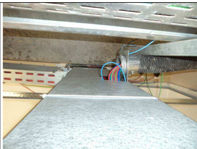
Figura 06E: eletrocalhas com septo divisor, alinhadas e tampadas.
