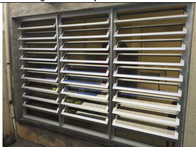
Figura 15C: Janela JA3 instalada na secretaria da 2ª VT.
