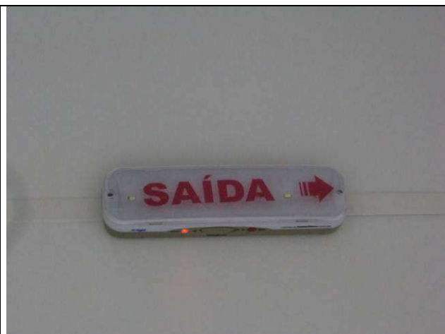
Figura 38E: blocos de emergência.
