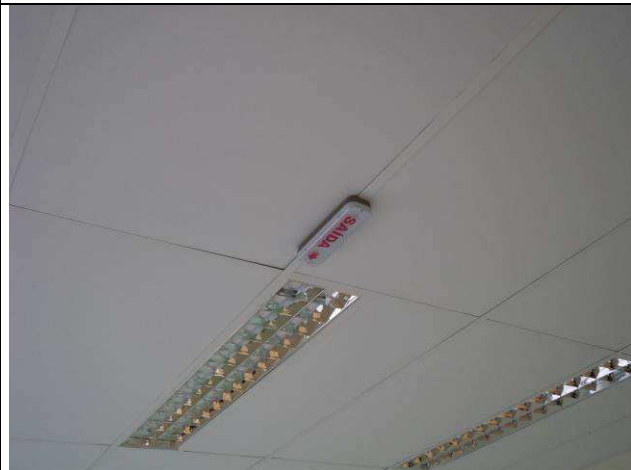
Figura 40E: luminárias 2x32W e blocos de emergência - audiências.
