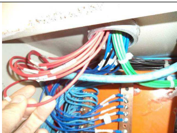
Figura 12E: cabeamento 2,5mm 2 Corfio - Corfitox - rede estabilizada.
