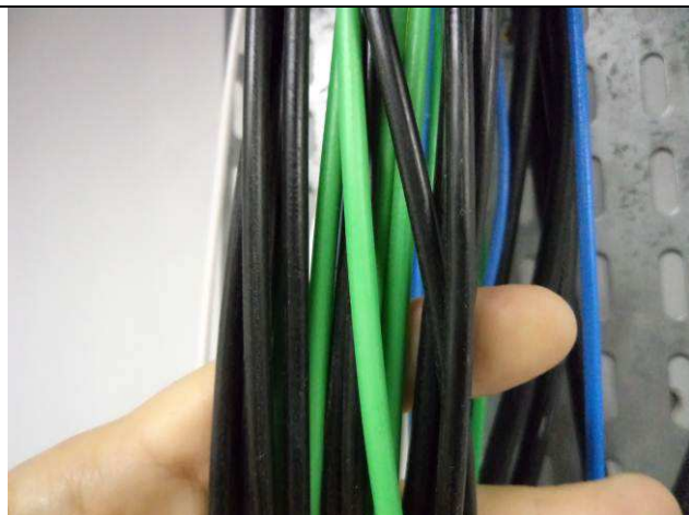
Figura 18E: cabecamento 4,0mm 2 Corfio - Corfitox - rede ar-condicionado.
