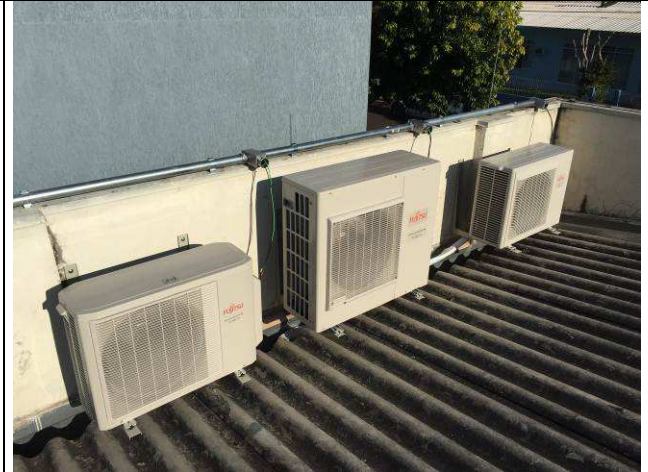
Figura 78C: Condensadoras na cobertura - 24.000, 30.000 e 18.000 BTU's.
