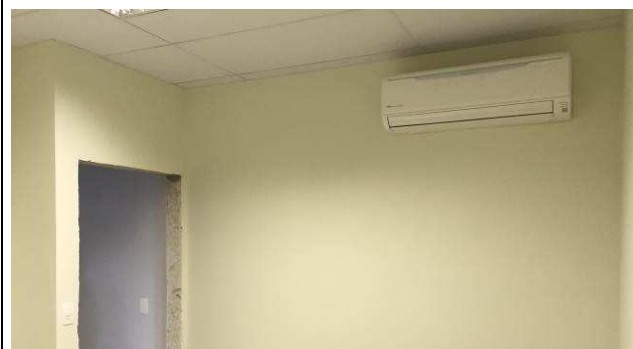
Figura 83C: Evaporadoras ASBA18LEC (18.000 BTU's) - gabinete do juiz e sala de conciliação.
