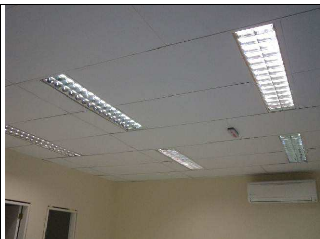
Figura 44E: luminárias 2x32W e blocos de emergência - fundos secretaria.
