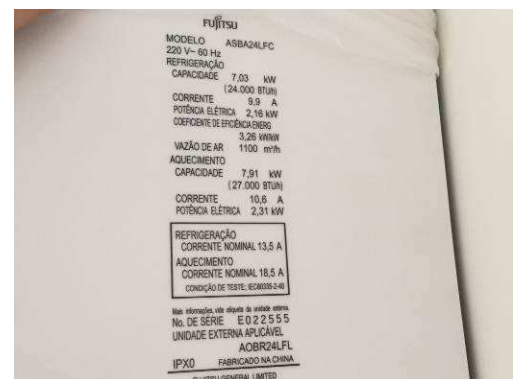
Figura 84C: Evaporadora ASBA24LFC (24.000 BTU's) - sala de audiências.
