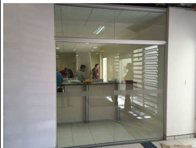
Figura 10C: Painéis de vidro VT1 reinstalados na área do balcão de atendimento da 2ª VT.
