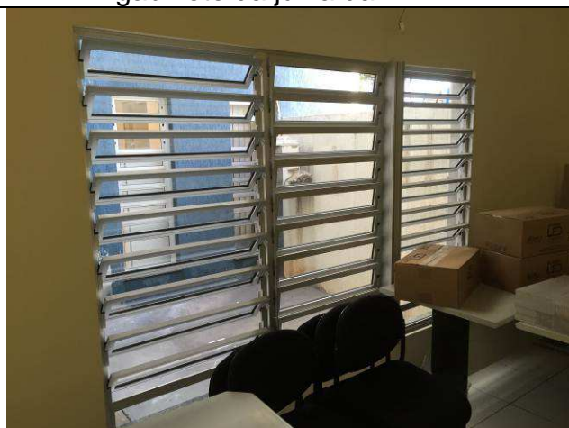
Figura 16C: Janela JA3 instalada na secretaria da 2ª VT.
