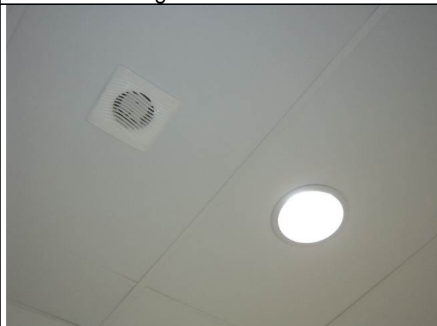
Figura 45E: luminária 23W e exaustor.
