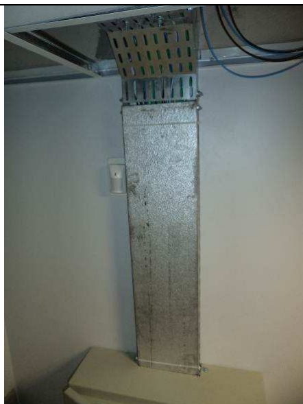
Figura 07E: eletrocalha descida quadro QDC, alinhada e tampada.
