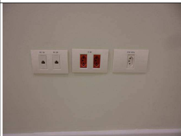
Figura 20E: tomadas elétricas - fase 2.
