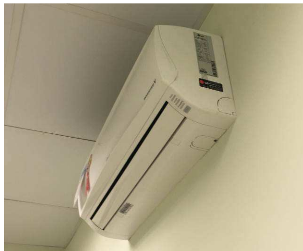
Figura 85C: Equipamento condicionador de ar (LG), tipo Split, sistema inverter, capacidade de refrigeração 9.000 BTU/h instalado na Sala de Conciliação.
