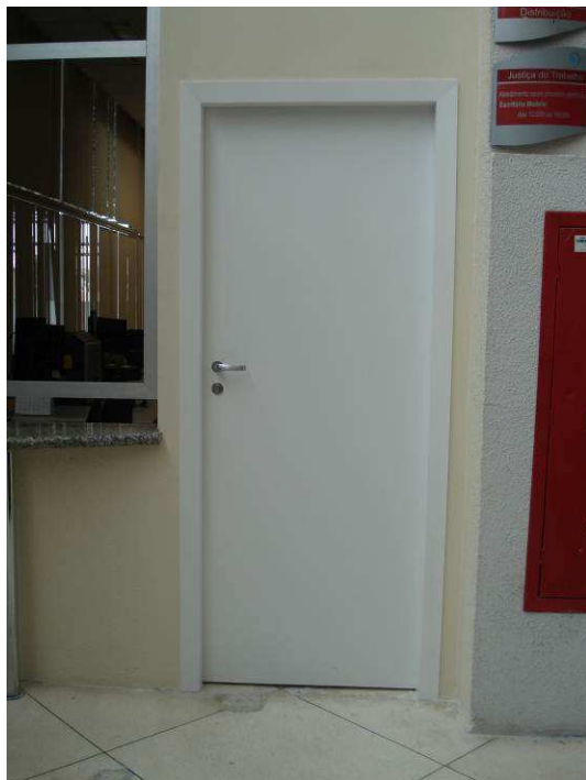
Figura 99C: Porta pintada no acesso à Distribuição.
