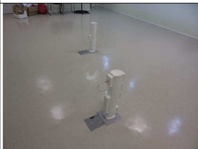
Figura 25E: Totens Dutotec, tomadas, porta equipamentos, caixa de passagem.
