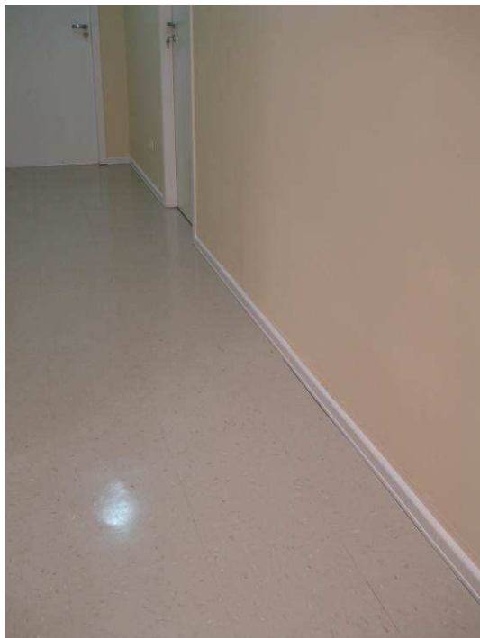
Figura 67C: Rodapé Santa Luzia, com 15 mm de espessura e 5 cm de altura, instalado na Circulação (5ª Vara).
