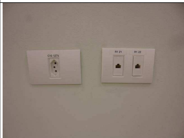
Figura 21E: tomadas elétricas - fase 2.
