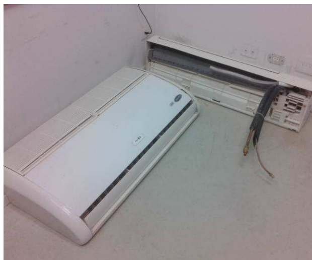
Figura 24C: Aparelhos de ar condicionado removidos dos espaços da Sala de Audiências I e Espera do Público.
