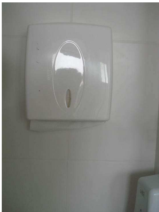
Figura 79C: Instalado dispenser para papel toalha no banheiro masculino do bloco de terceirizados.
