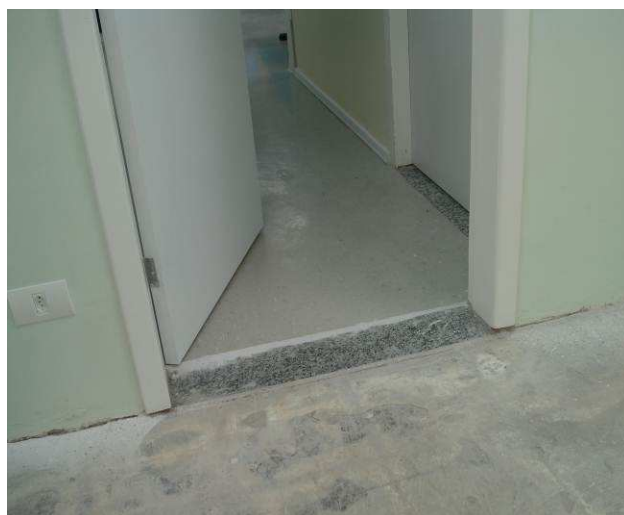
Figura 72C: Instalada soleira em granito cinza andorinha polido no vão da porta entre a Sala de Conciliação (fase 02) e a Secretaria da 5ª Vara (fase 01).
