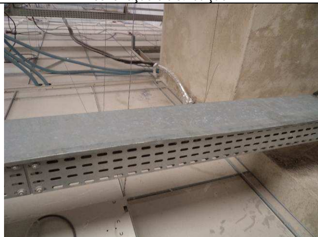
Figura 07E: eletrocalhas tampadas a alinhadas.
