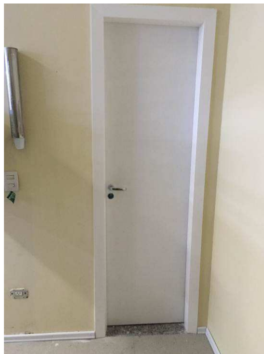
Figura 100C: Porta pintada no banheiro da Distribuição.
