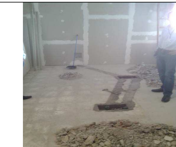
Figura 13E: eletrodutos sob o piso - sala de audiências.
