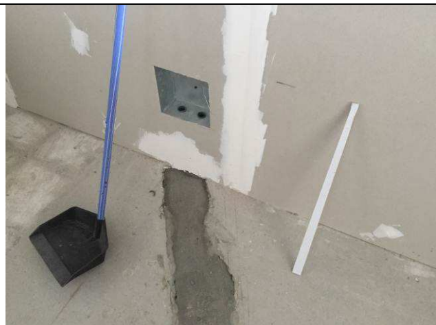
Figura 11E: caixas de passagem sala de audiências.
