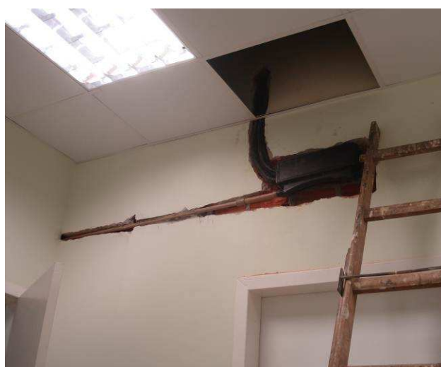
Figura 83C: Foi finalizada a rede frigorígena (conexão ao equipamento/carga de gás) para instalação de ar condicionado da Sala de Conciliação.
