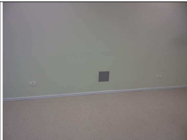
Figura 12E: caixas de passagem sala de audiências.
