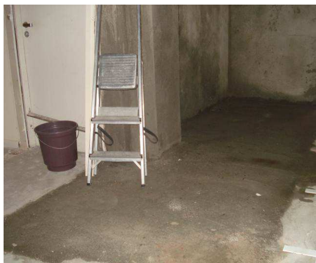
Figura 08C: Foi removido piso em concreto do banheiro anexo à Sala Site (em desnível, se comparado ao ambientes anexos).
