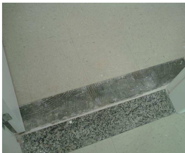
Figura 71C: Instalada soleira em granito cinza andorinha polido no vão da porta entre a Sala de Audiências I (fase 02) e Gabinete de Juiz I (fase 01).
