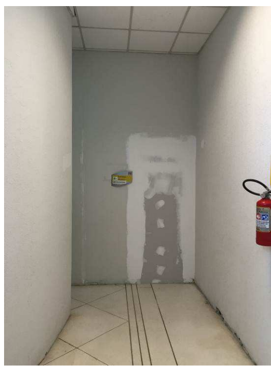
Figura 32C: Executado gesso acartonado duplo na no fechamento de vão de porta localizado entre a Sala de Audiências I e o hall de entrada do Fórum.
