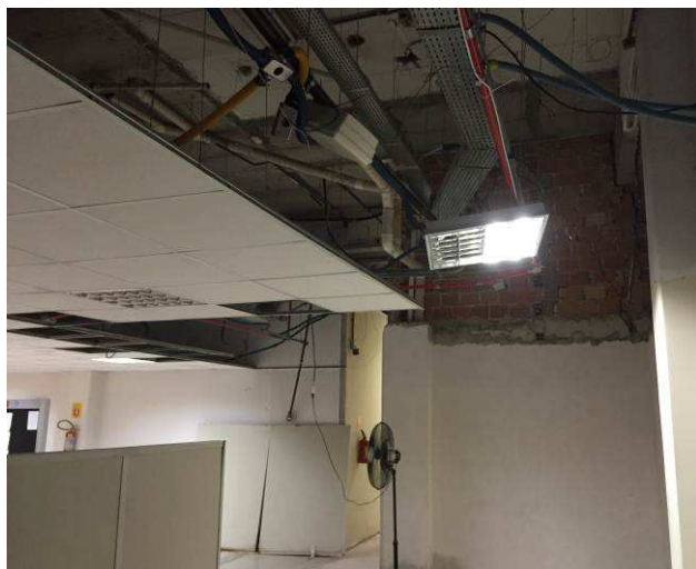
Figura 17C: Forro de gesso removido na Sala de Espera do público.
