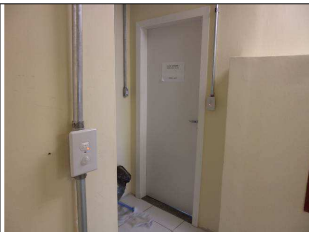
Figura 23E: Sensores de presença iluminação corredor fundos.
