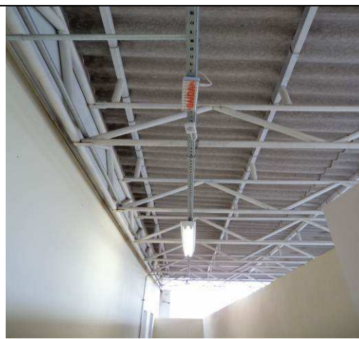
Figura 24E: Sensores de presença iluminação corredor fundos.
