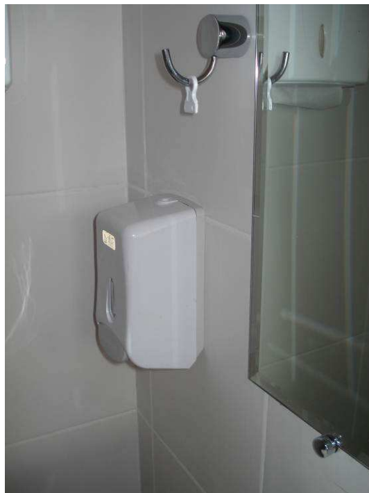
Figura 78C: Saboneteira de plástico instalada no banheiro masculino do bloco de terceirizados.
