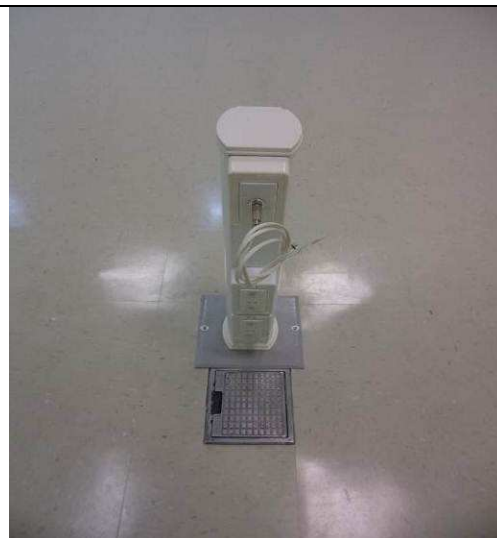
Figura 40E: instalação sonorização, pontos lógicos RJ45.
