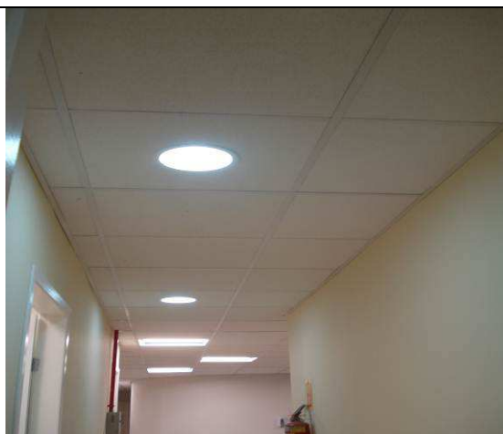
Figura 30E: blocos de emergência, luminárias 4x16W e luminárias 23W.
