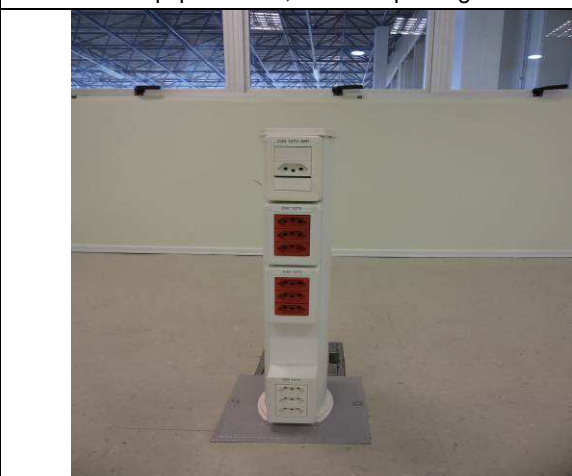
Figura 27E: Totens Dutotec, tomadas, porta equipamentos, caixa de passagem.
