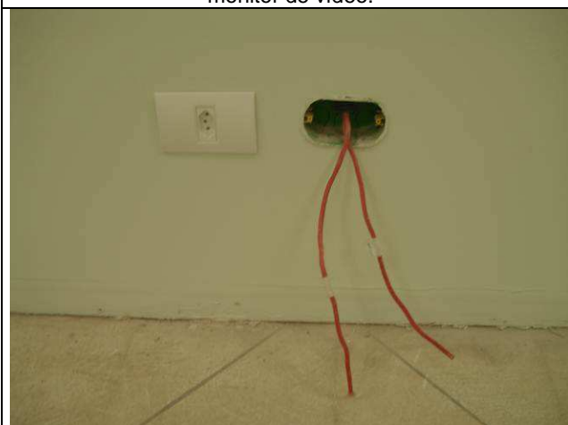
Figura 35E: cabeamento UTP cat6.
