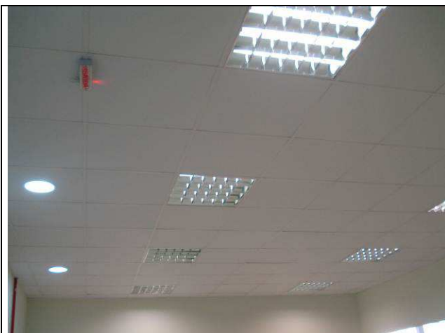
Figura 29E: blocos de emergência, luminárias 4x16W e luminárias 23W.
