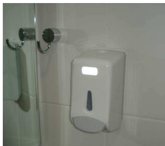
Figura 77C: Saboneteira de plástico instalada no banheiro feminino do bloco de terceirizados.
