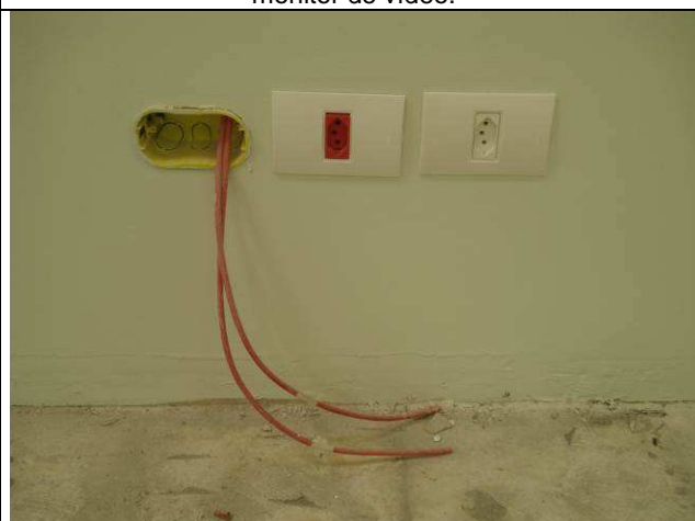
Figura 36E: cabeamento UTP cat6.
