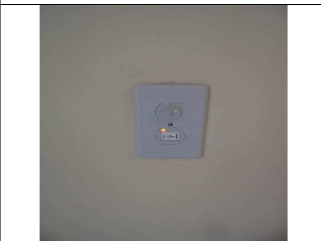
Figura 22E: Sensores de presença iluminação corredor fundos.
