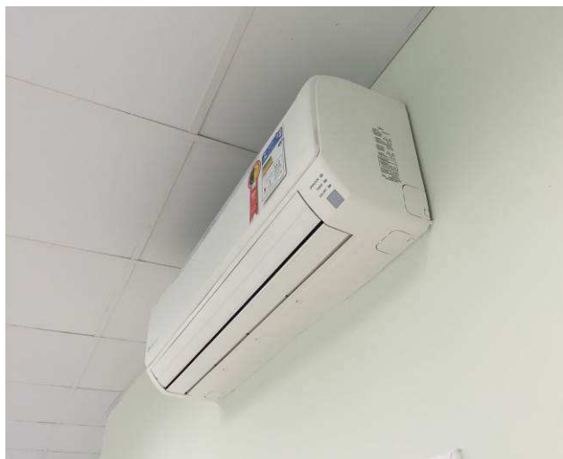
Figura 84C: Equipamento condicionador de ar (FUJITSU), tipo Split, sistema inverter, capacidade de refrigeração 27.000 BTU/h instalado na Sala de Audiências I.
