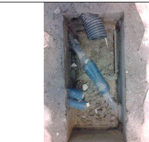
Figura 15E: eletrodutos sob o piso - sala de audiências.
