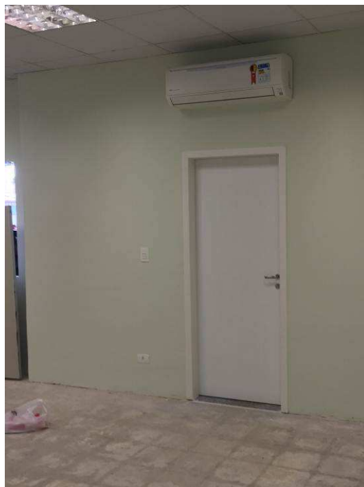
Figura 43C: Porta instalada na passagem da Sala de Audiências I para o Gabinete de Juiz I.
