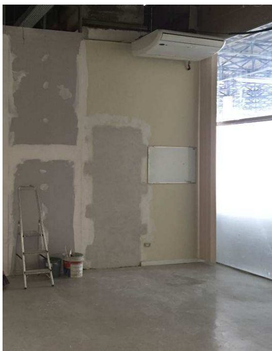
Figura 11C: Porta removida na passagem da sala de audiências I para banheiro da Distribuição (local fechado com gesso acartonado).
