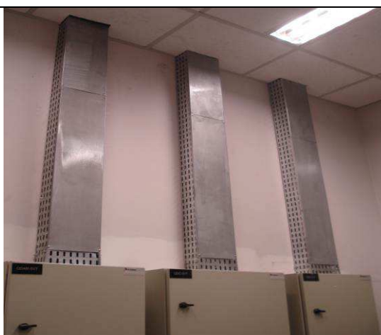
Figura 10E: eletrocalhas tampadas a alinhadas.
