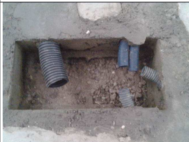
Figura 14E: eletrodutos sob o piso - sala de audiências.
