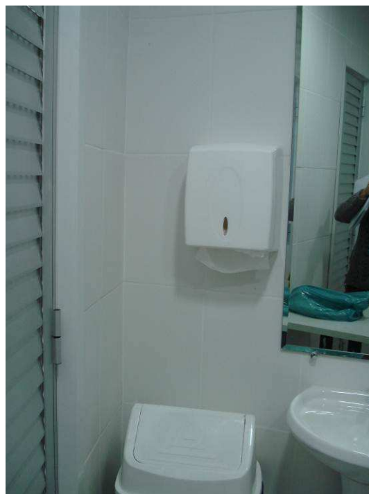
Figura 80C: Instalado dispenser para papel toalha no banheiro feminino do bloco de terceirizados.
