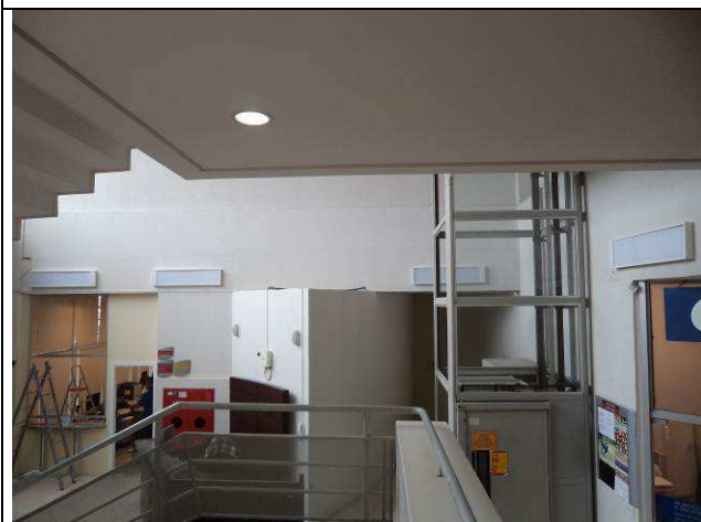
Figura 31E: 4 luminárias 2x32W hall principal.
