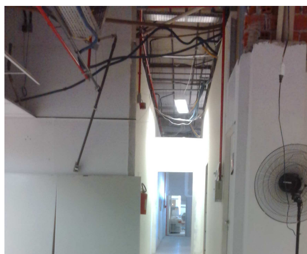
Figura 16C: Forro de gesso removido na área de acesso à Sala de Audiências e de Conciliação.
