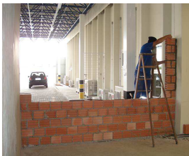
Figura 25C: Executada alvenaria na Sala de Audiências I, para instalação de janela J1A.
