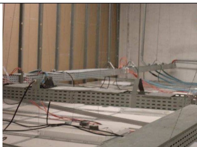
Figura 09E: eletrocalhas tampadas a alinhadas.
