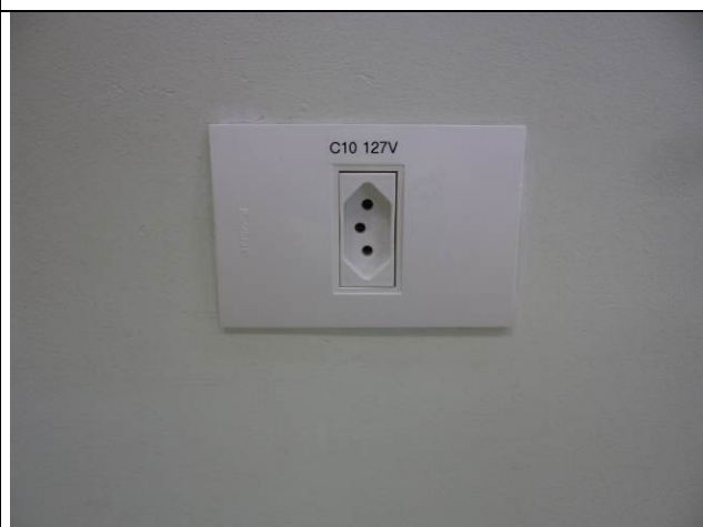
Figura 19E: tomadas elétricas - fase 2.
