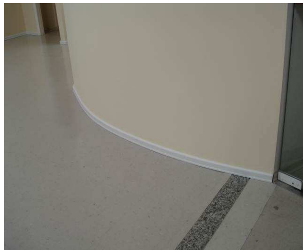
Figura 68C: Rodapé Santa Luzia, com 15 mm de espessura e 5 cm de altura, instalado na Sala de Espera do Público.
