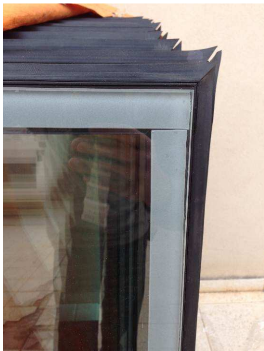
Figura 03: Esquadrias fornecidas inicialmente apresentavam fita colante em tom divergente das existentes.
