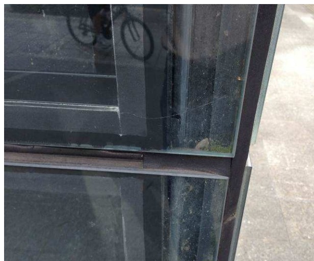
Figura 22: Detalhe de esquadrias de canto, em posição idêntica àquela onde decidiu-se pela não substituição das esquadrias.
