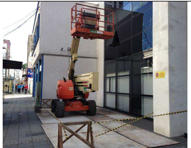
Figura 08: Equipamento em área isolada da calçada.
