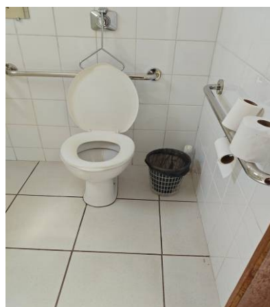
Ausência de alarme de emergência
