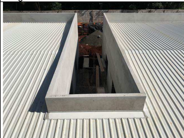
Figura 46C: Rufos de cobertura - Fórum.
