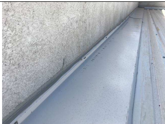
Figura 43C: Rufos de cobertura - Fórum.
