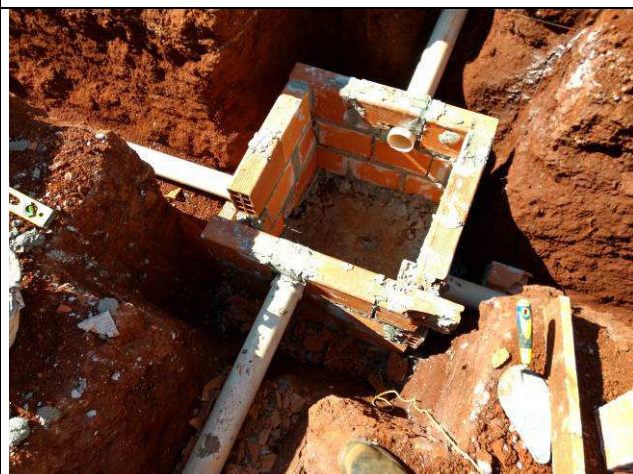
Figura 109C: Rede de coleta de esgoto - caixas de passagem - Fórum.
