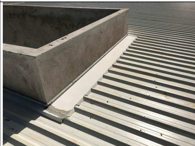
Figura 42C: Rufos de cobertura - Fórum.
