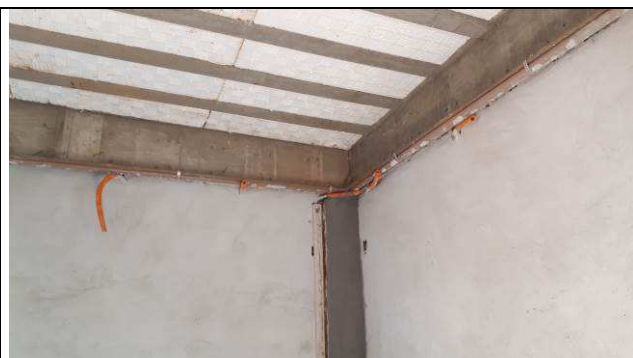
Figura 12E: Eletrodutos e caixas embutidas em alvenaria - segundo quadrante à direita.
