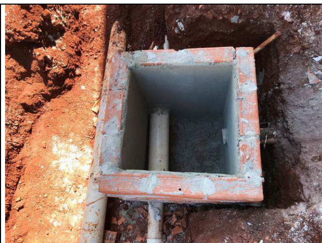
Figura 112C: Rede de coleta de esgoto - caixas de passagem - Fórum.
