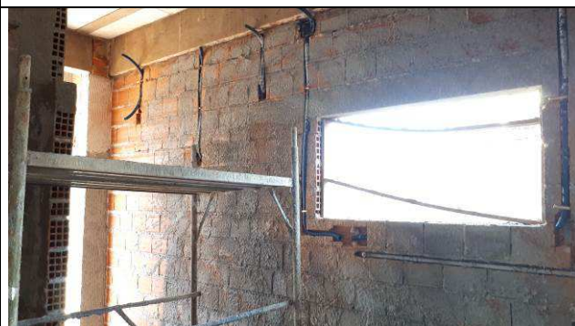
Figura 20E: Eletrodutos e abertura para caixas embutidas em alvenaria - segundo quadrante à esquerda.
