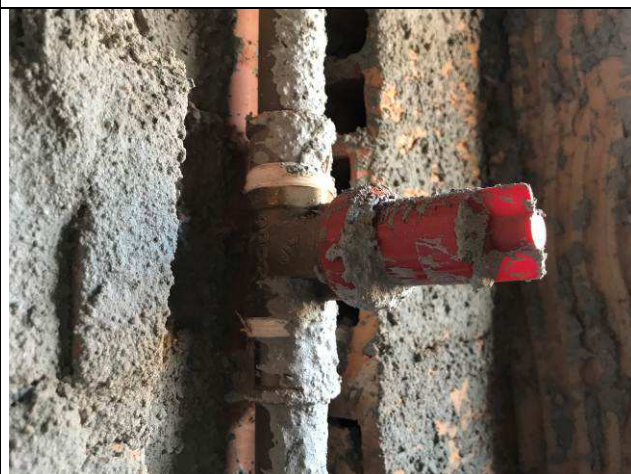
Figura 106C: Registro gaveta de 3/4" - água fria geral - Fórum.
