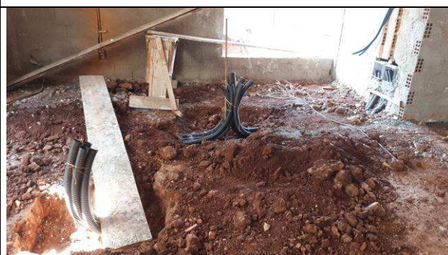
Figura 22E: Eletrodutos - pisos das salas de audiências - segundo quadrante à esquerda.
