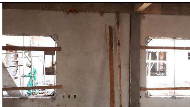
Figura 11E: Eletrodutos e caixas embutidas em alvenaria - segundo quadrante à direita.
