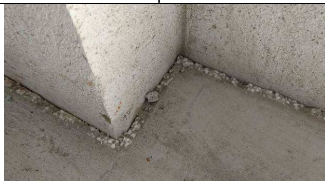
Figura 87C: Junta de isopor entre o contra piso e as paredes de alvenaria - Arquivo.
