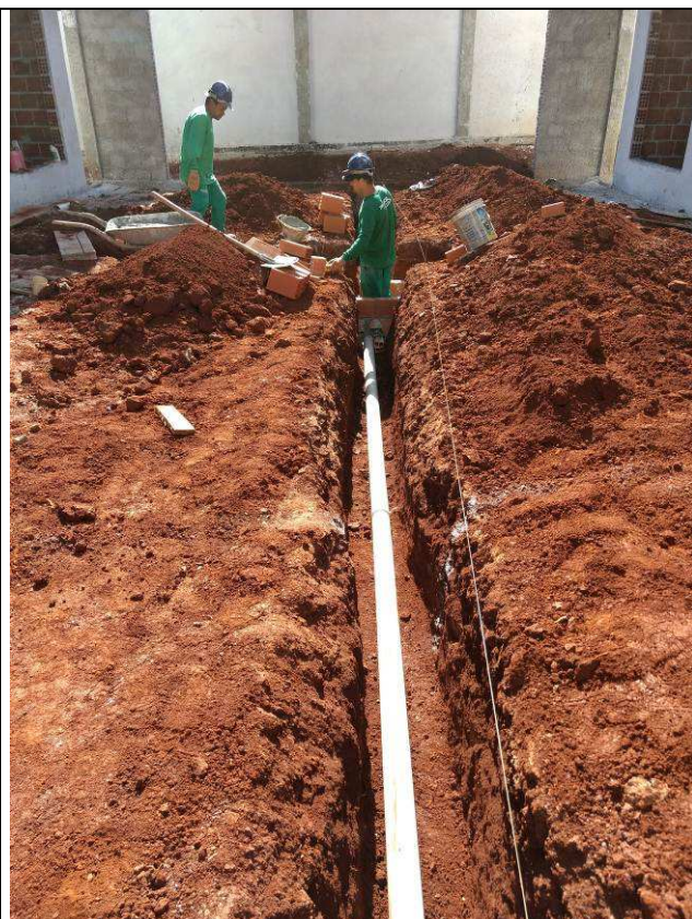
Figura 108C: Rede de coleta de esgoto - caixas de passagem - Fórum.
