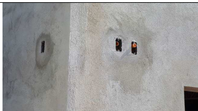
Figura 27E: Eletrodutos e caixas embutidas em alvenaria - Arquivo.
