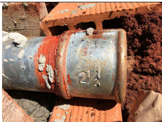
Figura 119C: Tubulação da rede de hidrantes - conexões.
