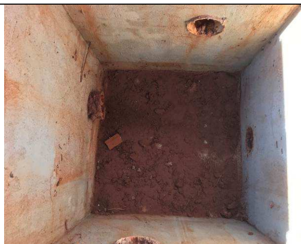
Figura 111C: Rede de coleta de esgoto - caixas de passagem - Fórum.
