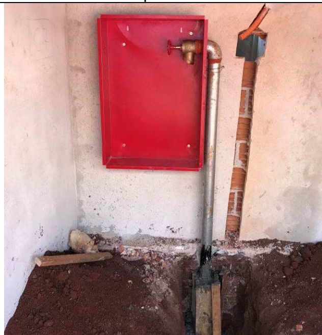
Figura 117C: Abrigo para hidrantes - Arquivo.
