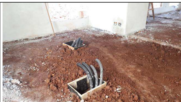
Figura 06E: Eletrodutos - pisos das salas de audiências - primeiro quadrante à direita.
