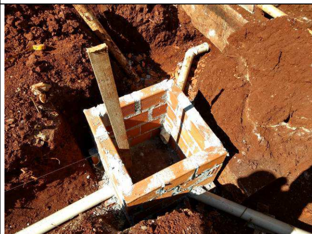
Figura 110C: Rede de coleta de esgoto - caixas de passagem - Fórum.
