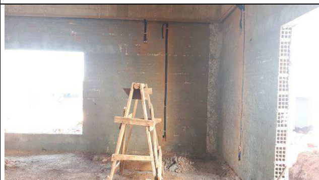
Figura 10E: Eletrodutos e abertura para caixas embutidas em alvenaria - primeiro quadrante à esquerda.
