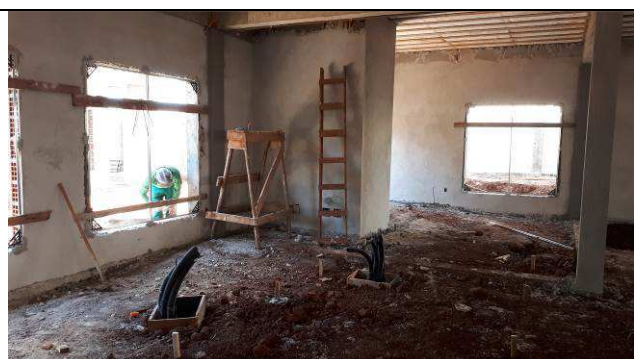
Figura 15E: Eletrodutos - pisos das salas de audiências - segundo quadrante à direita.
