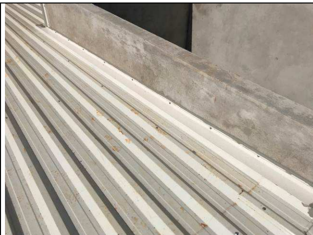
Figura 44C: Rufos de cobertura - Fórum.
