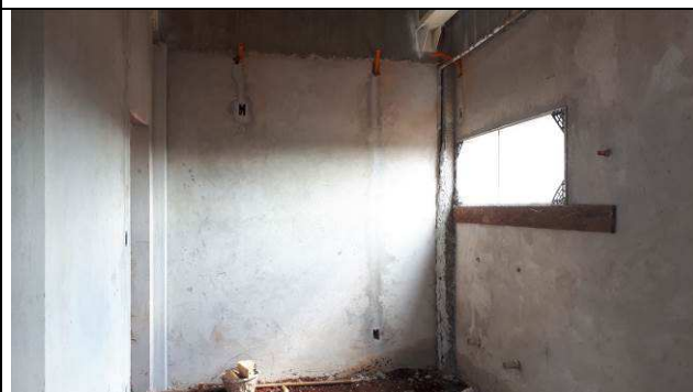
Figura 26E: Eletrodutos e caixas embutidas em alvenaria - Arquivo.
