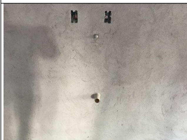
Figura 91C: Pontos de água e de esgoto - copa secretaria - Fórum.
