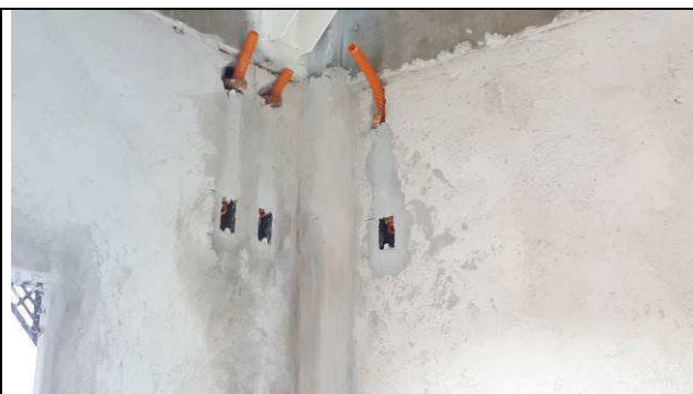
Figura 24E: Eletrodutos e caixas embutidas em alvenaria - Arquivo.
