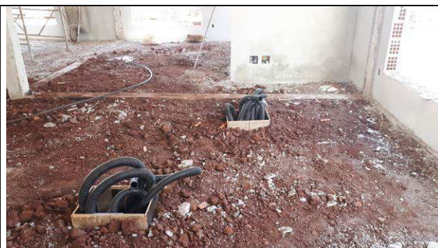
Figura 05E: Eletrodutos - pisos das salas de audiências - primeiro quadrante à direita.
