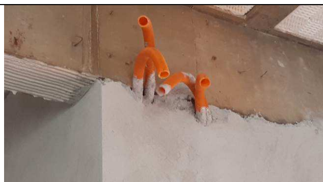
Figura 13E: Eletrodutos e caixas embutidas em alvenaria - segundo quadrante à direita.
