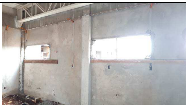
Figura 25E: Eletrodutos e caixas embutidas em alvenaria - Arquivo.
