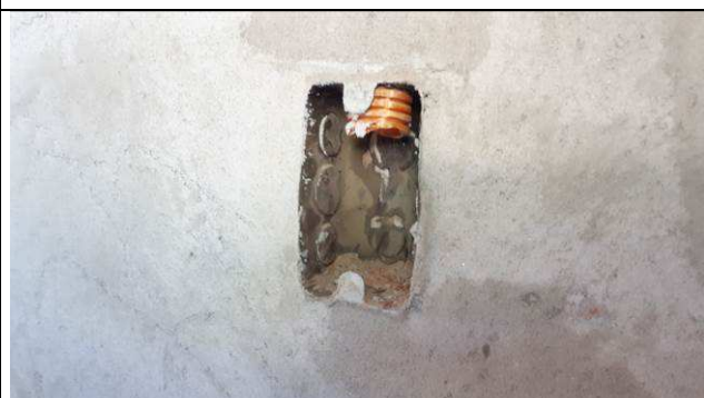
Figura 14E: Eletrodutos e caixas embutidas em alvenaria - segundo quadrante à direita.
